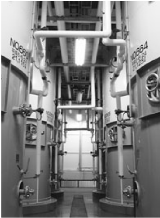
(左)仕込み蔵：1本2万l入るタンクが設置されている。
